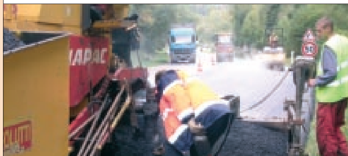
Intégrer la démarche SURE dans le programme d'entretien : cas du site pilote de la RN 138 dans l'Eure, entre Bernay et Saint-Denis-Des-Monts.
